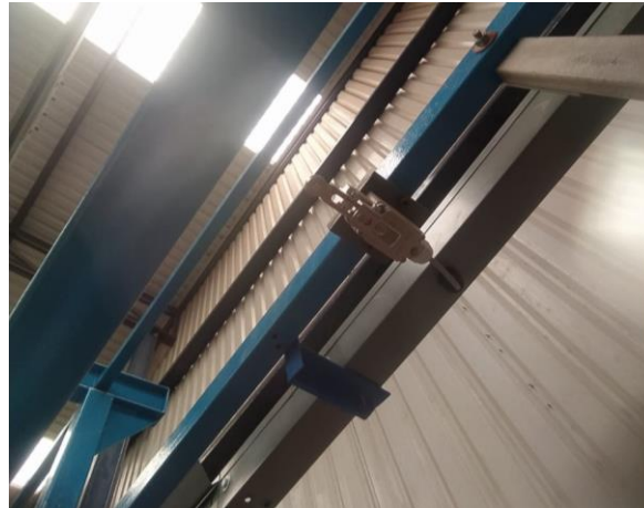
Fig. 61 Sensor de límite de carrera instalado.
