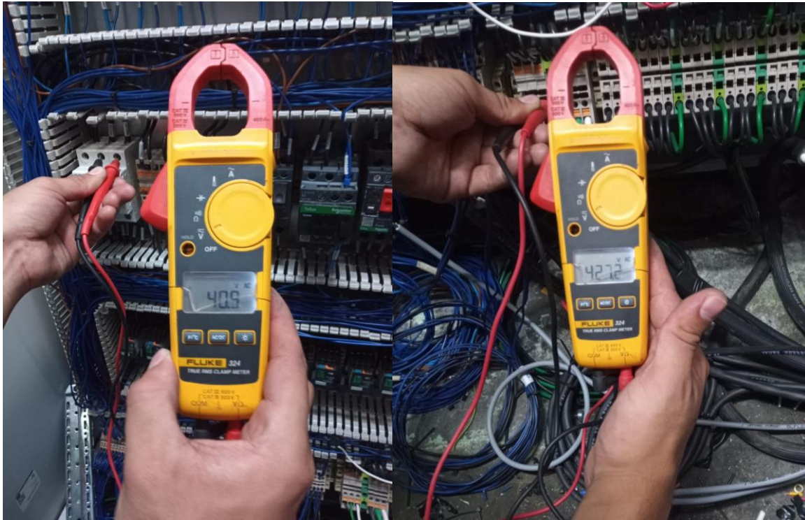
Fig. 52 Pruebas de voltaje 440 VAC y 42VAC
