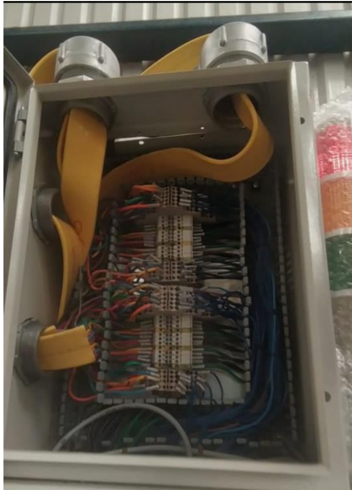
Fig. 56 Conexiones tablero auxiliar
