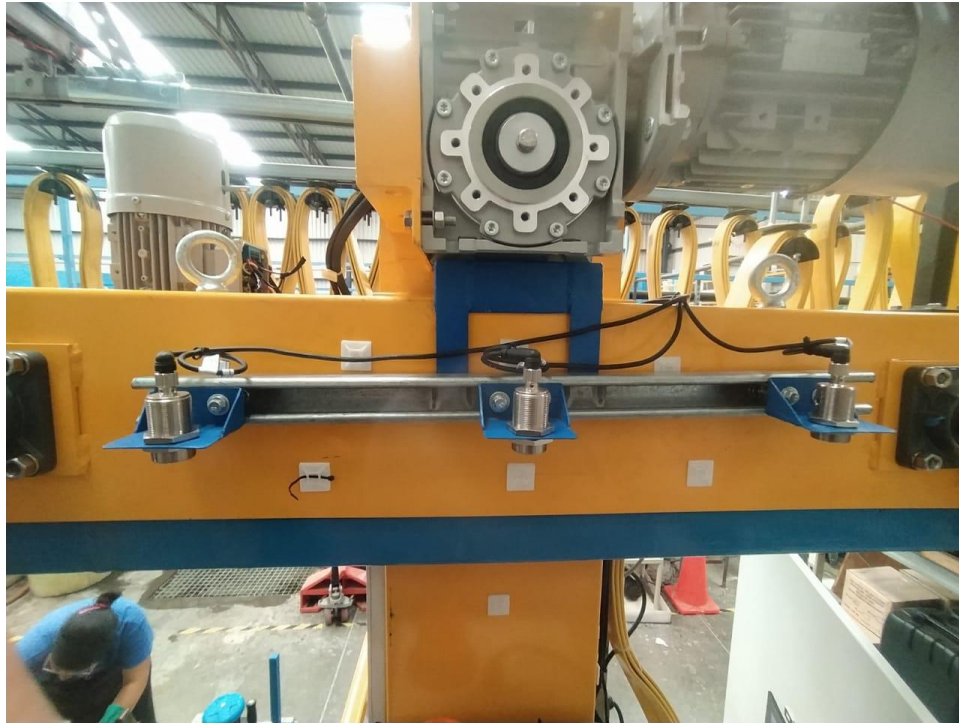
Fig. 65 Base y sensores instalados en grúa.
