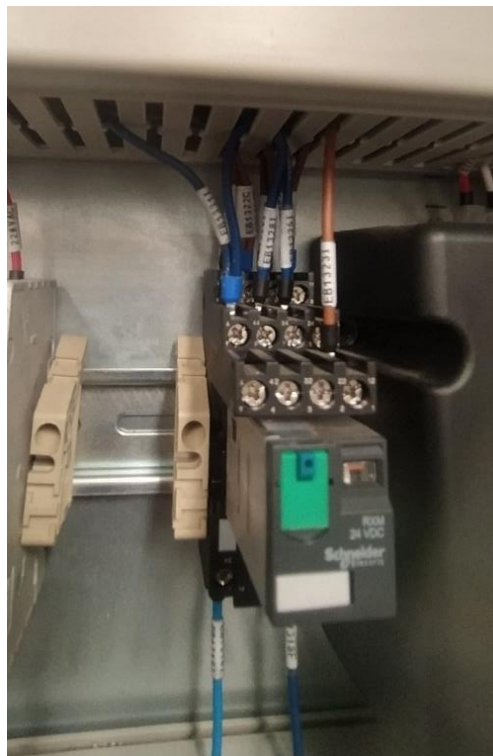
Fig. 51 Ejemplo de etiquetado de cables.
