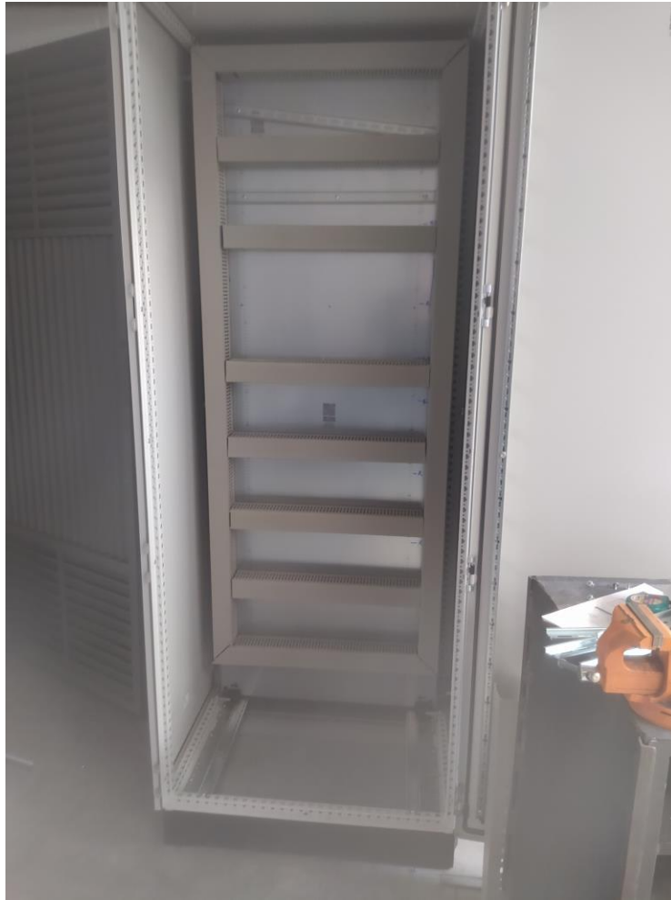
Fig. 41 Canaleta instalada en gabinete
