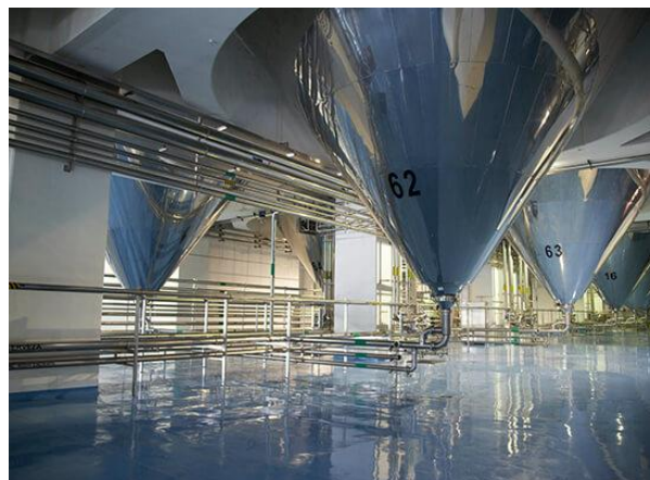
Figura 2.4 Tanques de Cuartos Fríos Fuente: Grupo Modelo, 2018
