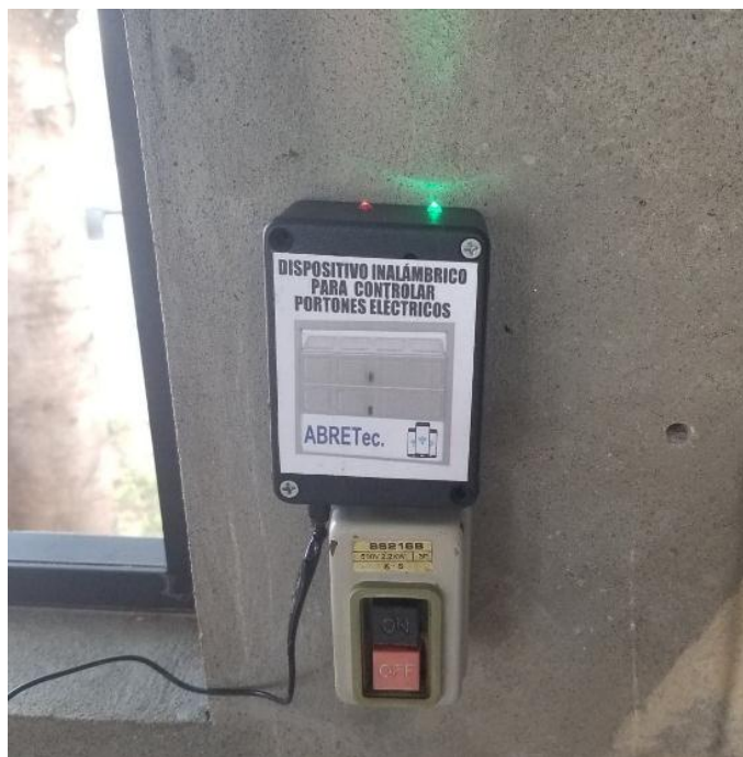
Figura 33. Dispositivo instalado operando.
