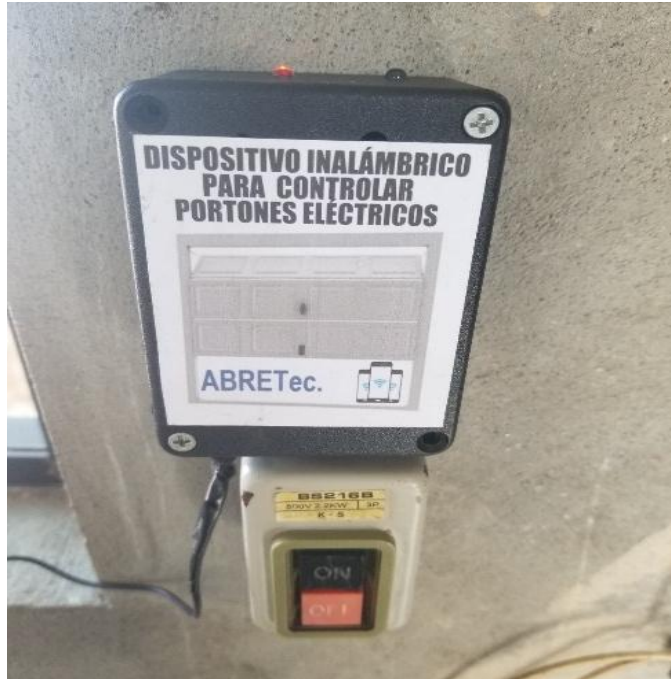
Figura 32. Dispositivo instalado encendido.
