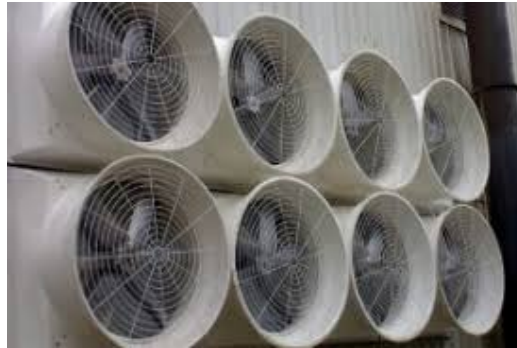
Figura 2.7: Ventiladores usados para la ventilación mecánica.
