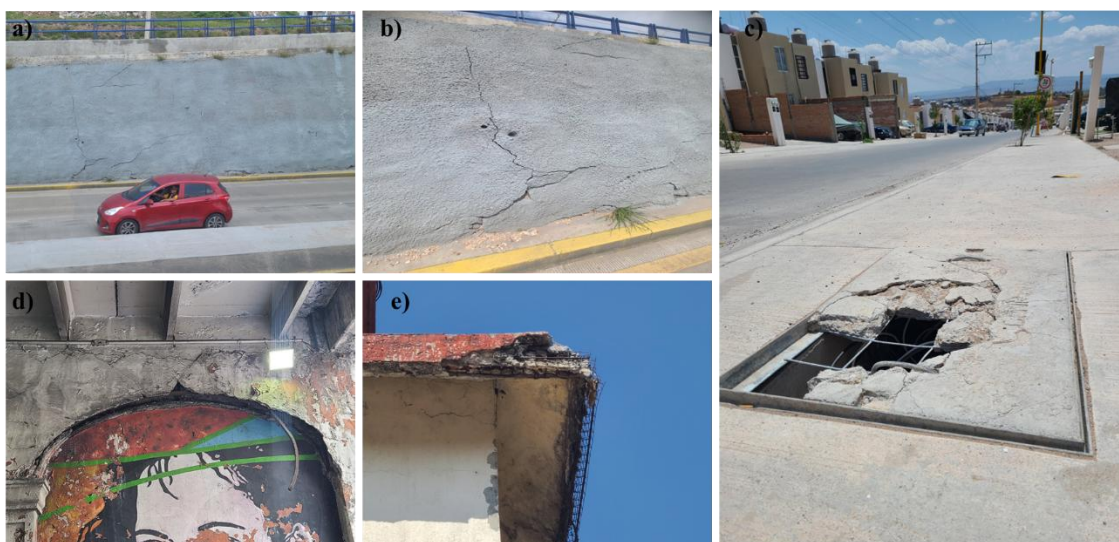
Figura 1.4. Ejemplos de estructuras deterioradas en Aguascalientes cuya durabilidad pudo haberse incrementado mediante el uso de concreto reforzado con fibras, a y b: hormigón proyectado para la estabilización de taludes en Ave. Siglo XXI a la altura de Col. Pintores Mexicanos, c: losa prefabricada para cableado de internet en Col. Real del Sol, d: túnel de Ave. 5 de mayo debajo de la Plaza Patria, e: Techo de edificio en la Colonia Primo verdad INEGI.
