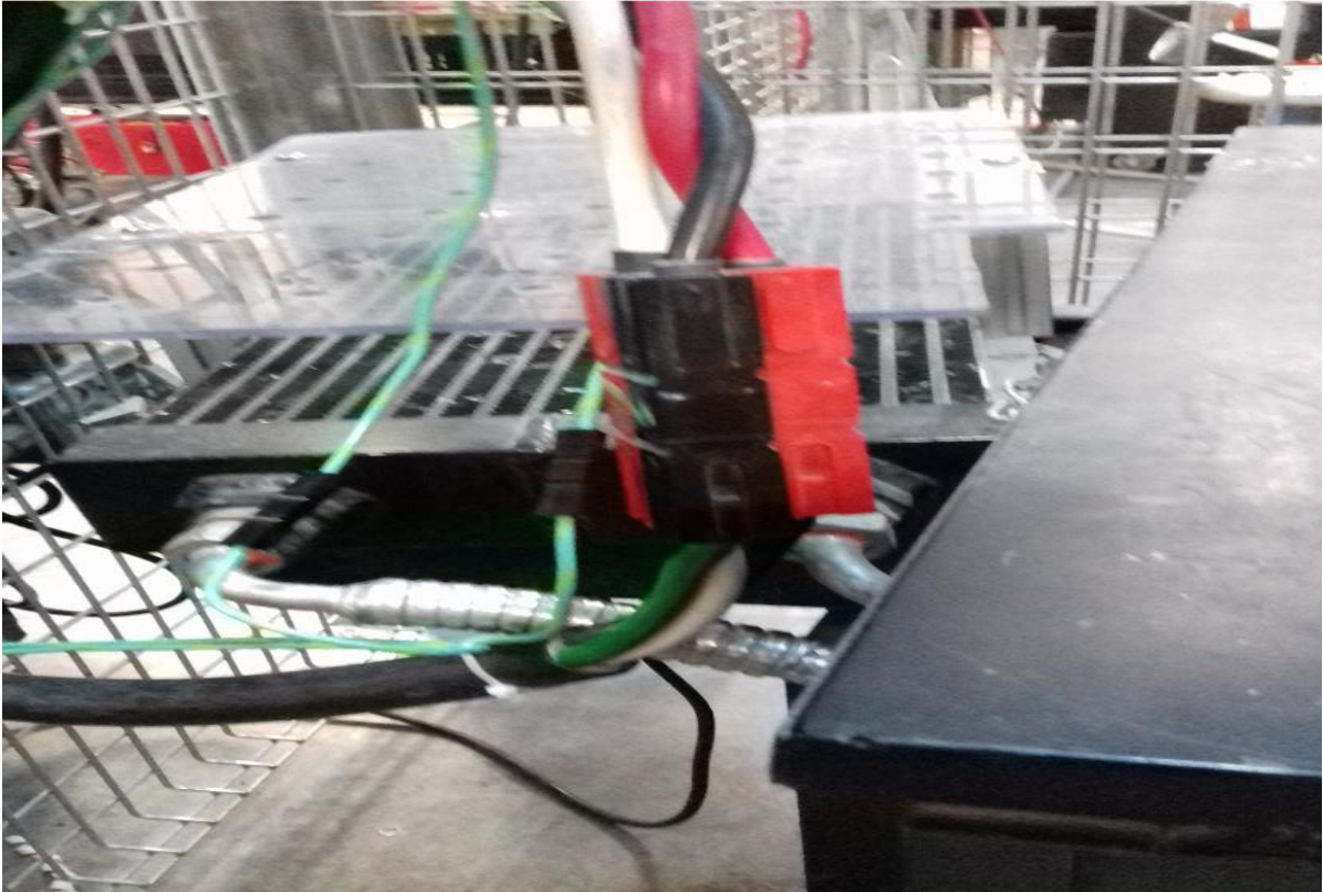
Figura 75 - Líneas de alimentación trifásicas de 480vac de la subestación hacia el variac.
