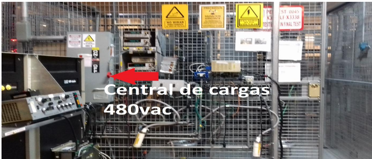
Figura 56 - Central de cargas de 480vac de la estación 045.
