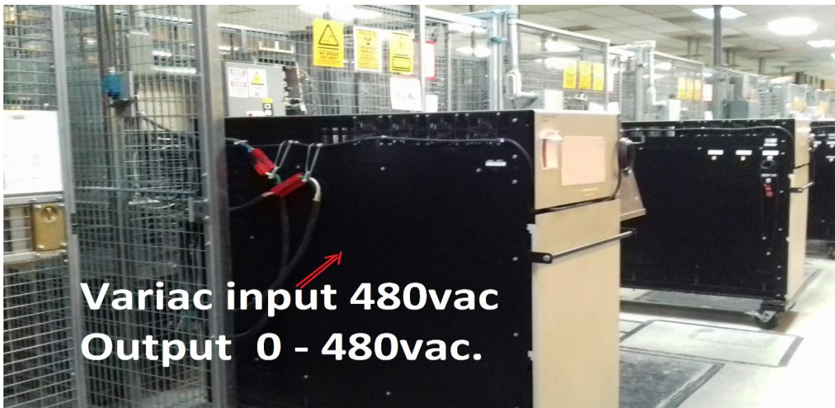
Figura 54 - Variac de 0-480vac instalado fuera de la estación 045.
