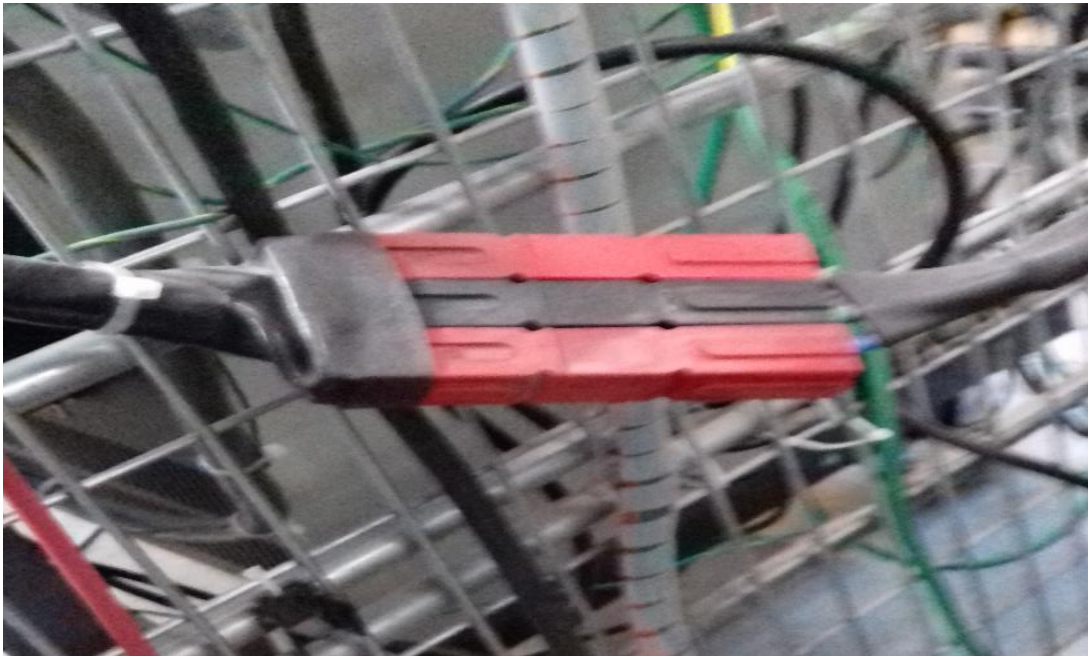
Figura 74 - Líneas trifásicas del variac a la unidad con conectores Anderson.
