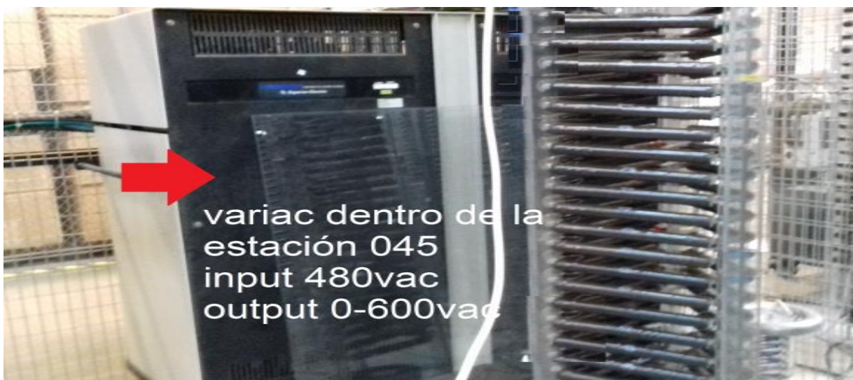
Figura 55 - Variac de 0-600vac instalado dentro de la estación 045.
