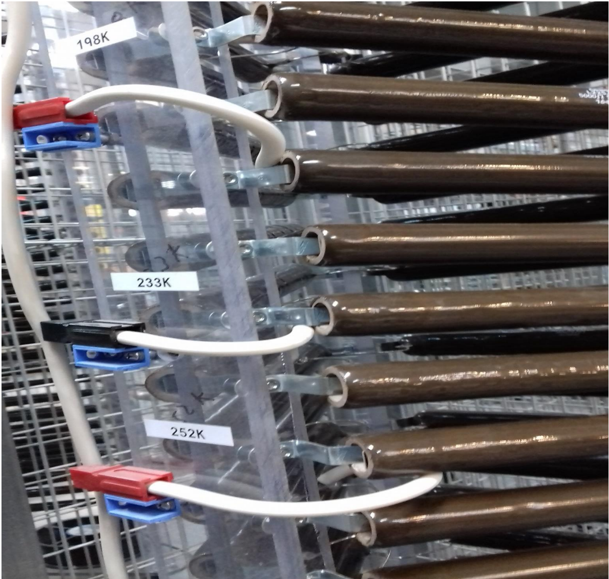
Figura 63 - Conectores Anderson instalados en las resistencias de la carga con su valor.
