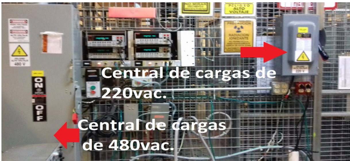
Figura 57- Estación de pruebas 045 con dos centrales de cargas 220vac y 480vac.
