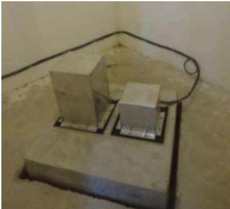
Fig. 9. Sismómetro y acelerómetro triaxiales dentro de caseta de monitoreo sísmico.
