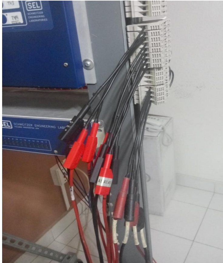
Figura 4. 5.- Conexión de los cables que inyectan las mediciones
