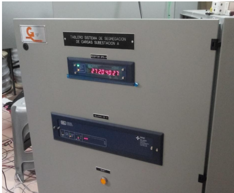
Figura 4. 19.- Sitio distribuido, subestación F
