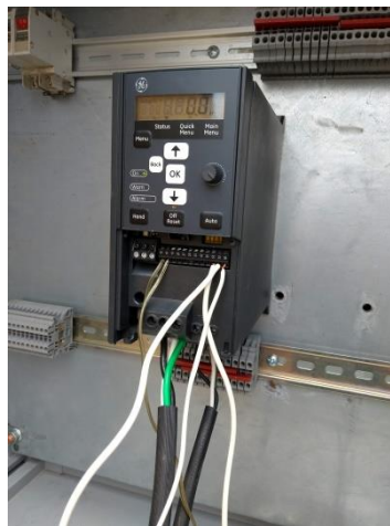
Figura Variador de velocidad funcionando
