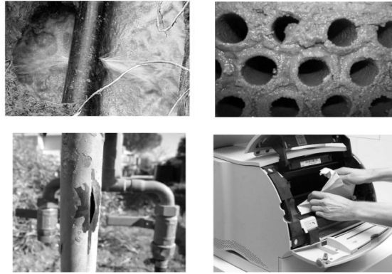
Figura 1.8: Fuga en una tubería de agua, suciedad en un intercambiador de calor, fisura en una tubería de agua y ejemplo de un atasco de hojas en una impresora.
