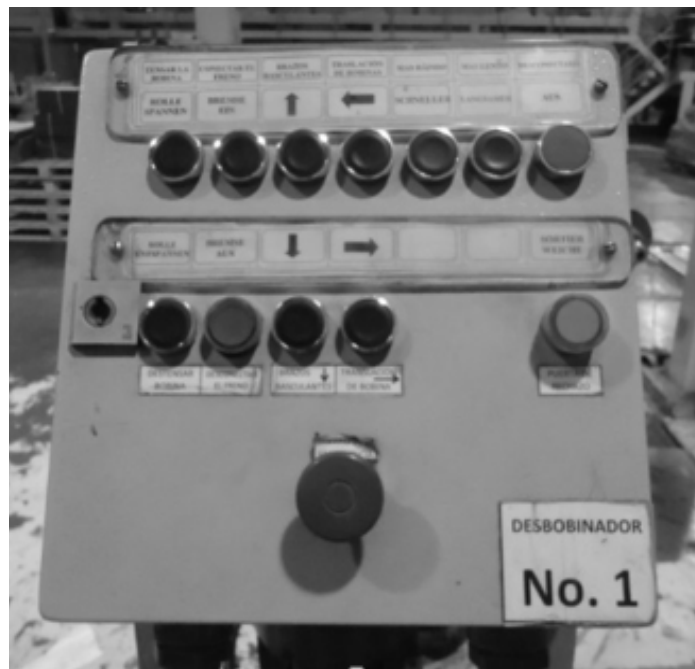
Figura 4.4 Estación de mandos local desbobinador.
