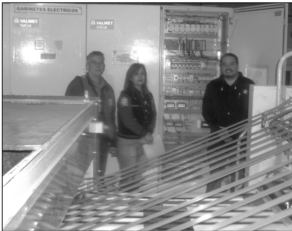
Figura 4.38 Vista de gabinete eléctrico y PLC S7-300.
