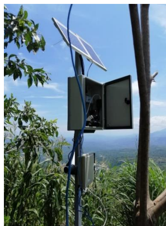
Figura 4.42 Torre de comunicaciones
