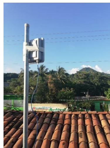
Figura 4.54 Instalación de la antena Ansell: "Tecnológico Cochoapa"
