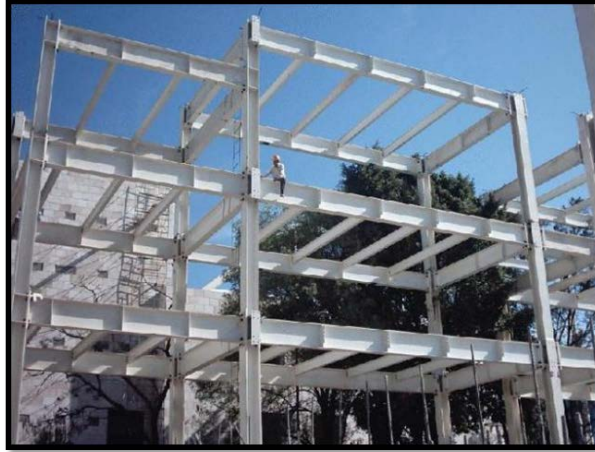
Figura 3. 35 Ejemplo de perfil de acero utilizado para fabricación de estructura
