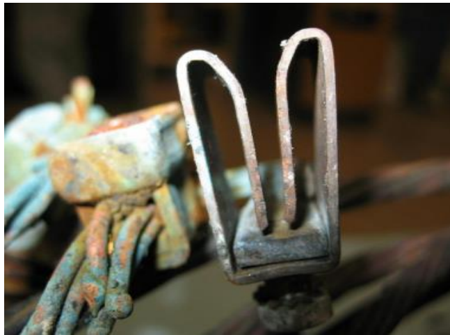
Figura 7. Mordaza mecánica dañada.
