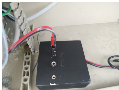
Fig. C.3.3. Mini tablero de conexiones de corriente directa
