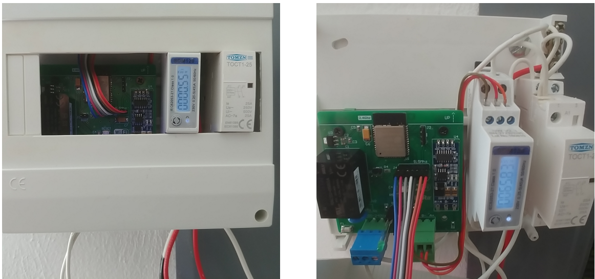
FIGURA 4.3: Imágenes del nodo medidor.
