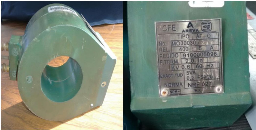
Figura 3.1. Transformador de Corriente de Prueba.
