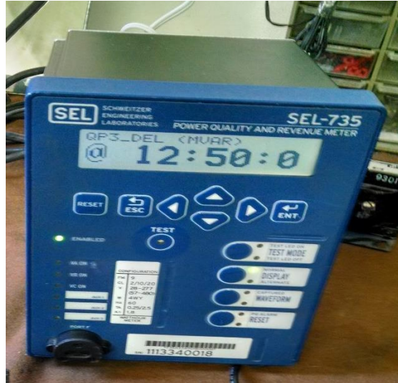
Figuras 3.28. Medidor de energía SEL-735.
