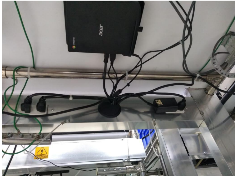
Figura 15. Instalación de Chrome método actual. Fuente área de IT Soporte de equipo de cómputo.
