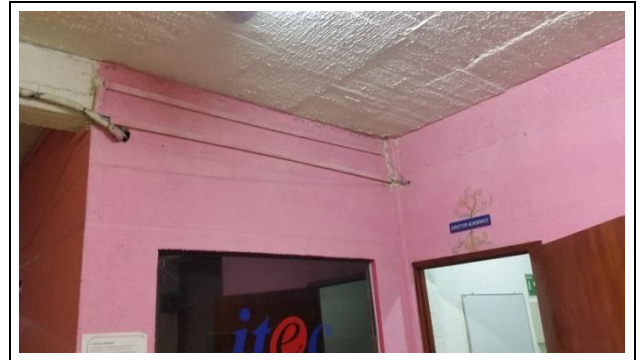
Figura 120. Canaletas fuera de la dirección.
