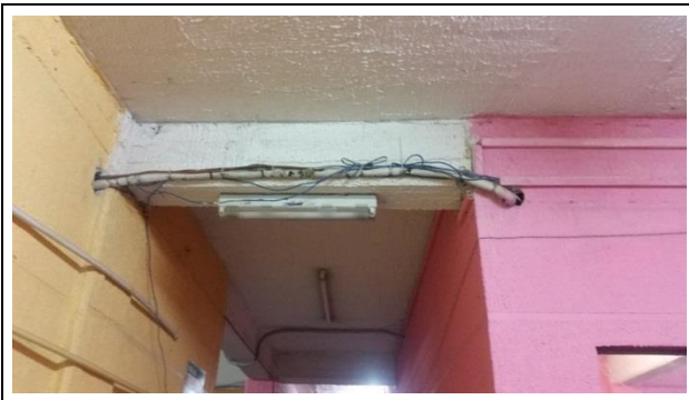
Figura 127. Cable de red en los pasillos.
