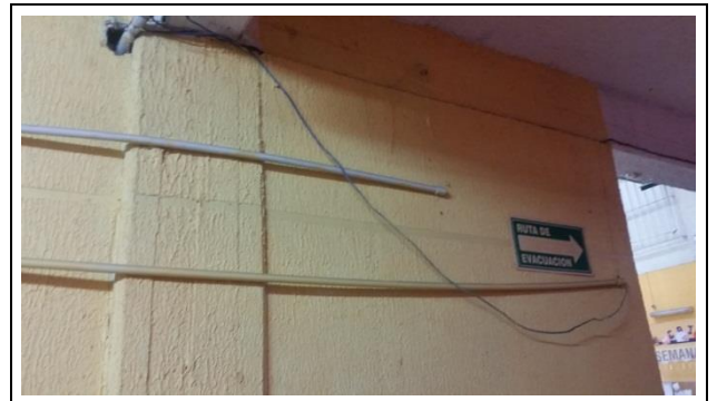
Figura 128. Cable de red en los pasillos.
