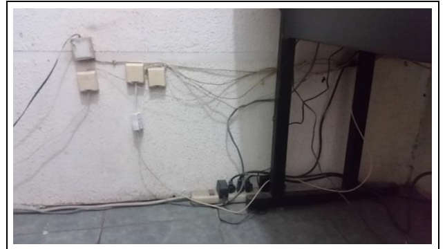
Figura 126. Instalación telefónica y eléctrica.
