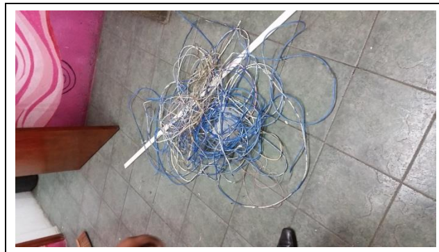
Figura 121. Cable de red.
