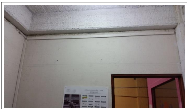
Figura 130. Canaletas del centro de cómputo.
