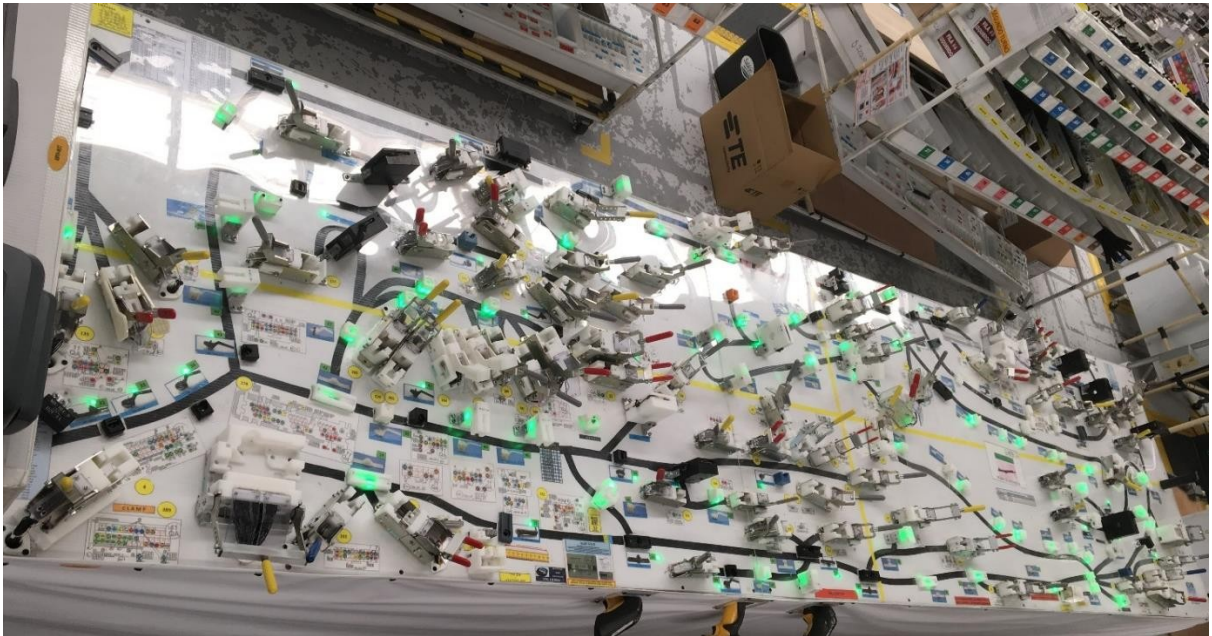
Imagen 58 Tablero de prueba eléctrica actual, liberado y colocado en línea de producción, con número de parte "Z" cargado, vista superior izquierda. Foto por Eduardo Trujillo.
