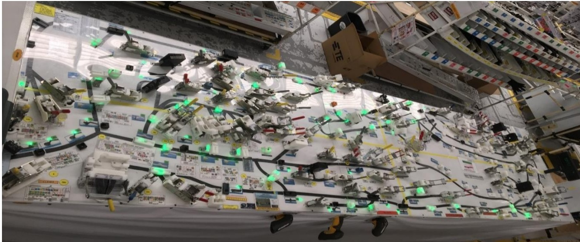
Imagen 56 Tablero de prueba eléctrica actual, liberado y colocado en línea de producción, con número de parte "Y" cargado, vista superior izquierda. Foto por Eduardo Trujillo.
