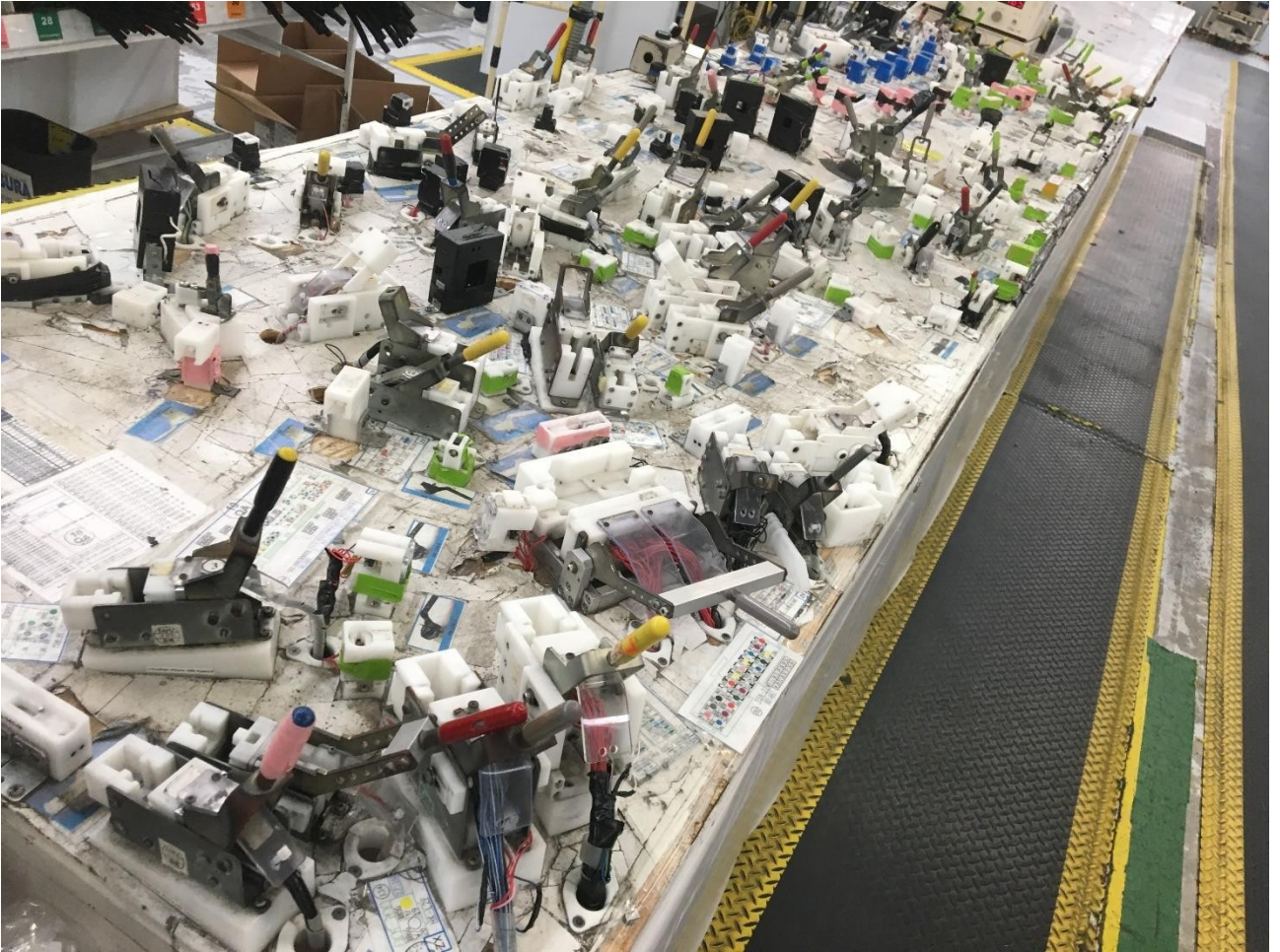
Imagen 52 Muestra del estado del tablero de prueba eléctrica antecesor a la construcción del tablero actual, vista lateral izquierda. Foto por Eduardo Trujillo.
