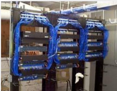
Centro de cableado
