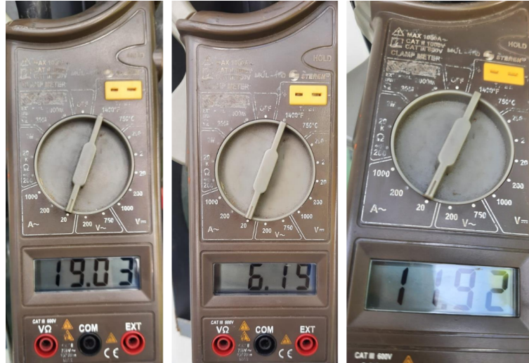
Figura 4.3: Comprobación de Consumo con Amperímetro de Gancho Radio Tropicana S.A De C.V Ubicación AV. Unión y Michoacán
