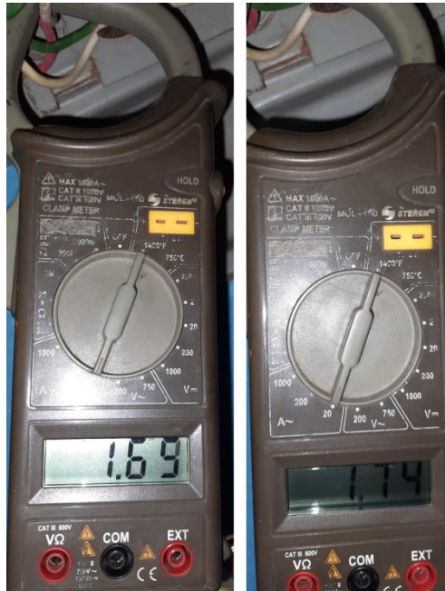
Figura 4.6: Comprobación de Consumo con Amperímetro de Gancho Radio Club S.A de C.V Ubicación AV. Arcadia Sector Popular
