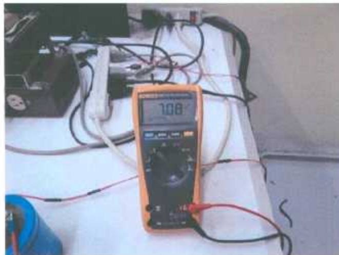
Figura 6.22 Voltaje de batería en modo carga con convertidor reductor-elevador, panel fotovoltaico y MPPT
