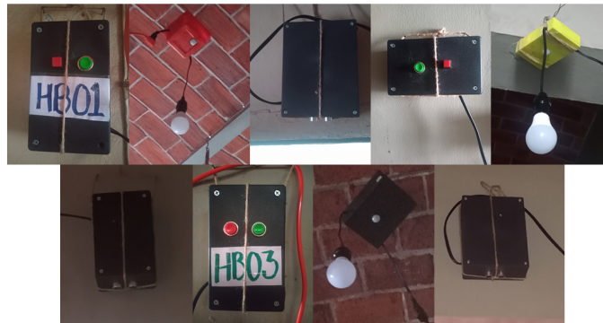
Figura 45: Módulos que integran el sistema con control inteligente.
