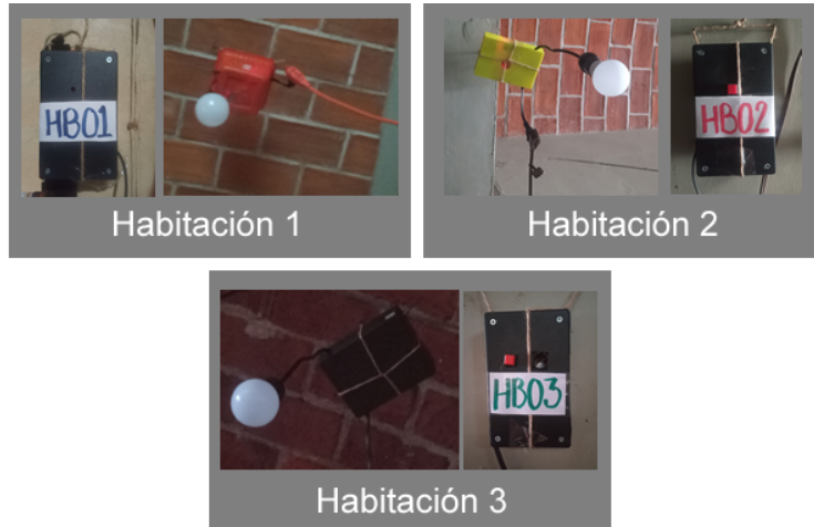
Figura 51: Módulos instalados por habitación.
