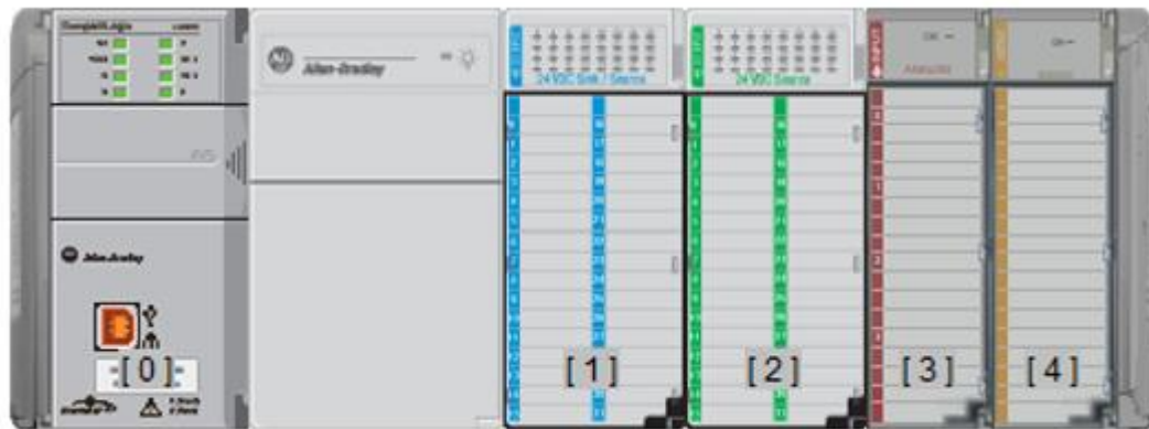
Imagen 23. Rack de control con PLC L30ER [0], fuente 1769-PA2, módulo 1769-IQ32 [1], módulo 1769-OB32 [2], módulo 1769-IF4 [3], módulo 1769-OF4 [4] y tapa terminadora 1769-ECR.
