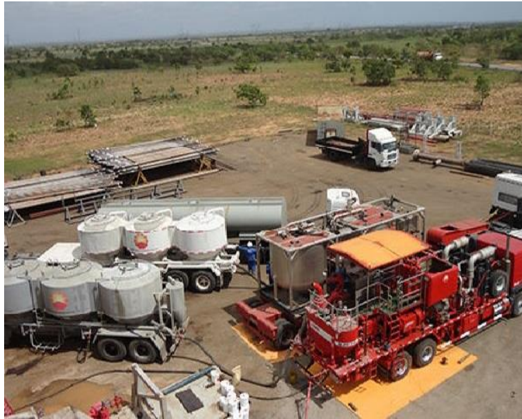
Fig. 2.22 Equipo de cementación superficial (López, R., 2018).
