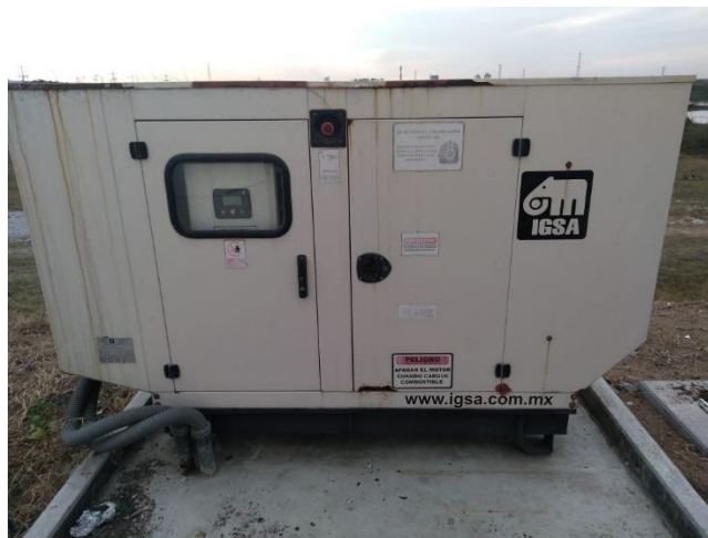
Figura 2.11. Planta de energía.
