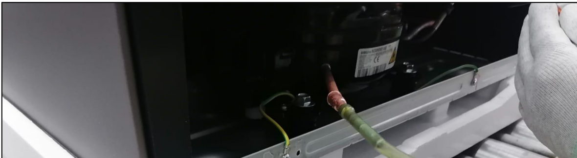
Figura 44. Conexión de tubería para barrido de nitrógeno.
