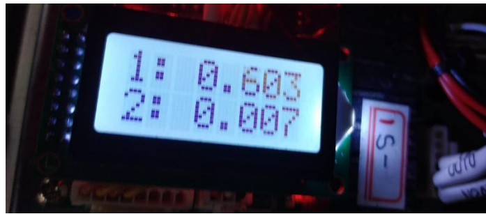
Figura 38. Valor de presión fuera de especificación entregada por equipo pressure.
