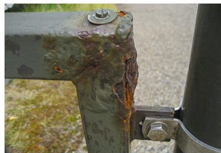
Ilustración 1. Corrosión galvánica presente en un acoplamiento de acero inoxidable e hierro fundido.
