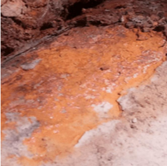
a) Fotografía tomada del acoplamiento de dos metales de una estructura.
