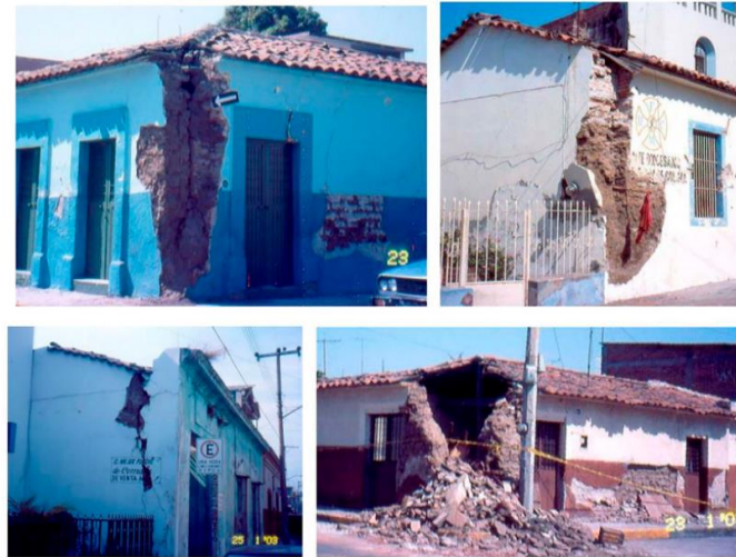
Figura 7. Grietas verticales y Colapso de Esquinas.
