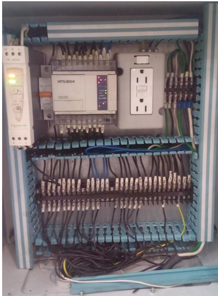
Figura 3-31 Panel del PLC del Kaizekuzen.
