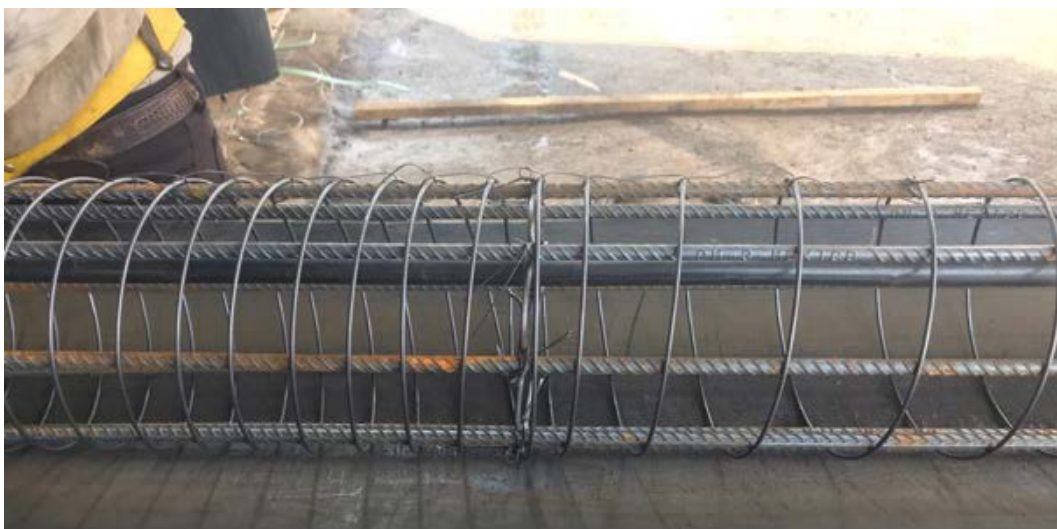
Figura 7.3: Zunchado del poste de concreto reforzado PCR- 9C-400.
