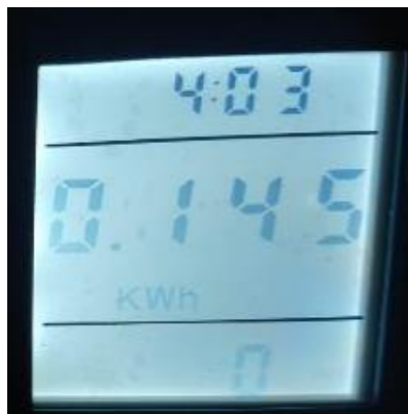
Figura 2. Consumo de energía del circuito eléctrico para el control de luminarias. Datos por una semana.
