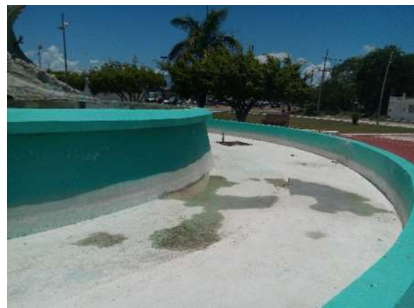
FIGURA 4.2 FUENTE FUERA DE SERVICIO, PARQUE DE LOS CAIMANES
