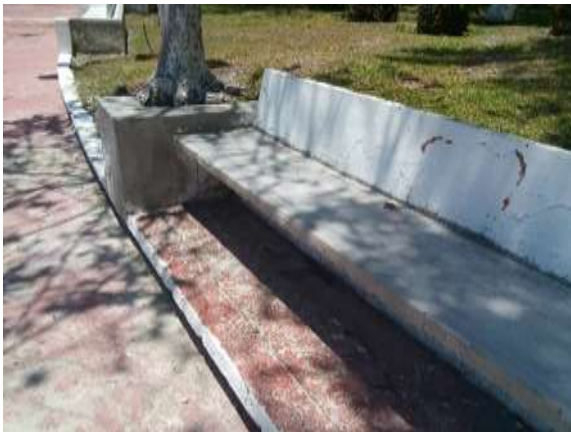
FIGURA 4.1 MOBILIARIO DETERIORADO Y ANDADORES EN MAL ESTADO, PARQUE DE LA ALAMEDA
