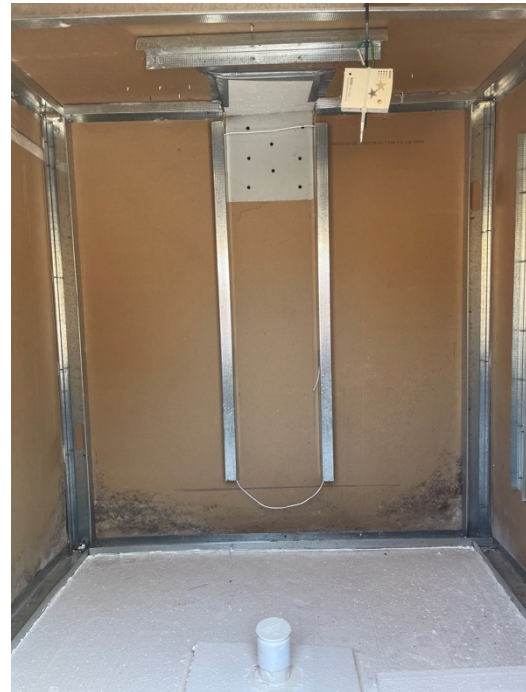
Imagen 10.- Planta y vista del interior. Instalación del HOBO U12-012 al interior del módulo experimental. fuente: elaboración propia.
