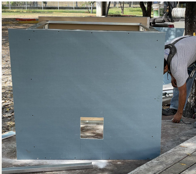
Imagen 11.- Ventana de captación de aire, Fuente: Propia.
