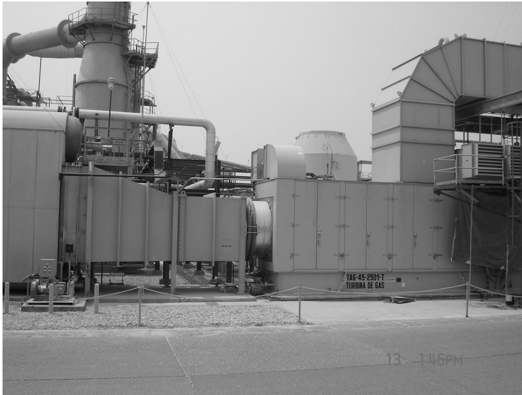
Figura 5.2: Turbina de gas y ducto de salida de gases al HRSG.
