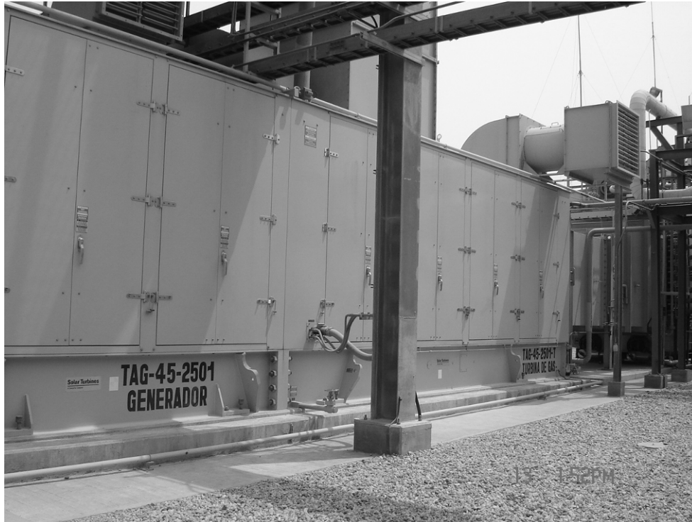
Figura 5.4: Conjunto generador y turbina de gas.
