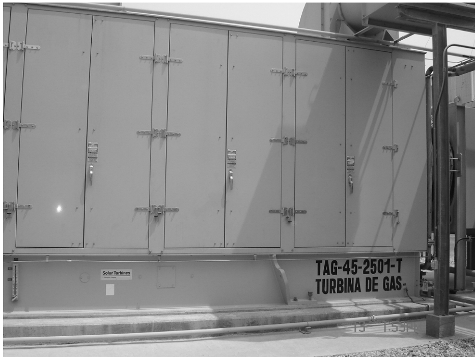
Figura 5.5: Turbina de gas
