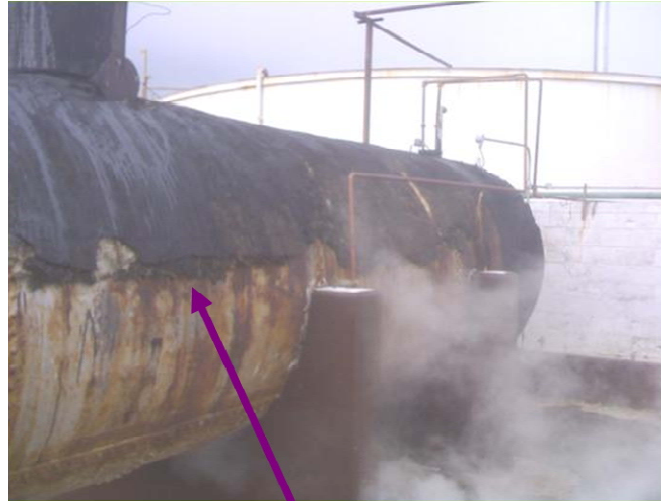
Figura 3.10 Tanque Receptor de Combustóleo
