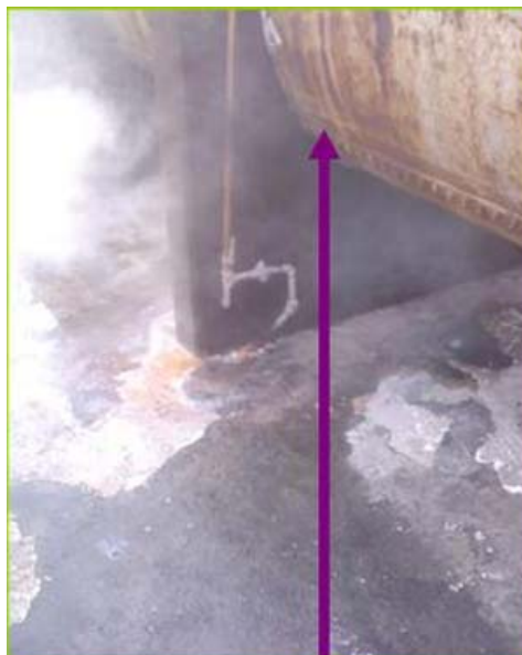
Figura 3.9 Tanque Receptor de Combustóleo
