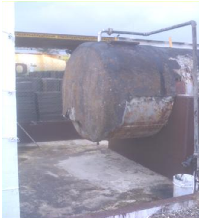
Figura 3.7 Tanque Receptor de Combustóleo.
