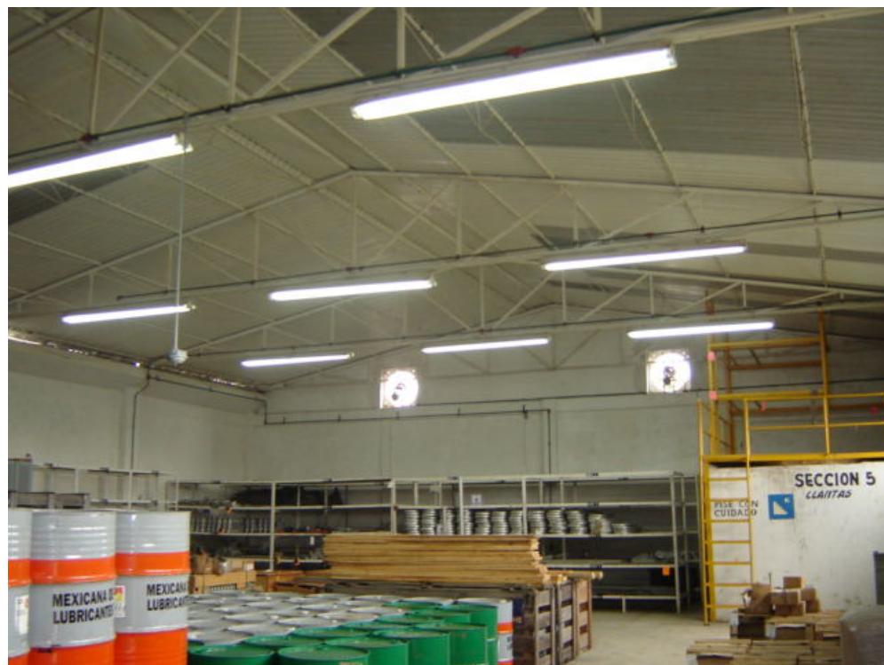
Figura. 4.5.1.5 Almacén General con canaleta de lámparas fluorescentes de 2 x 75 W.
