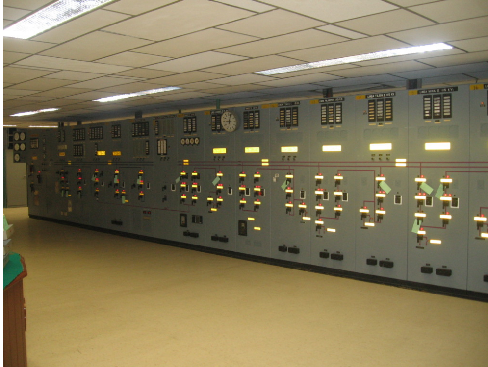
Figura. 4.5.1.4 Caseta de control con gabinetes de lámparas fluorescentes de 2 x 59 W.
