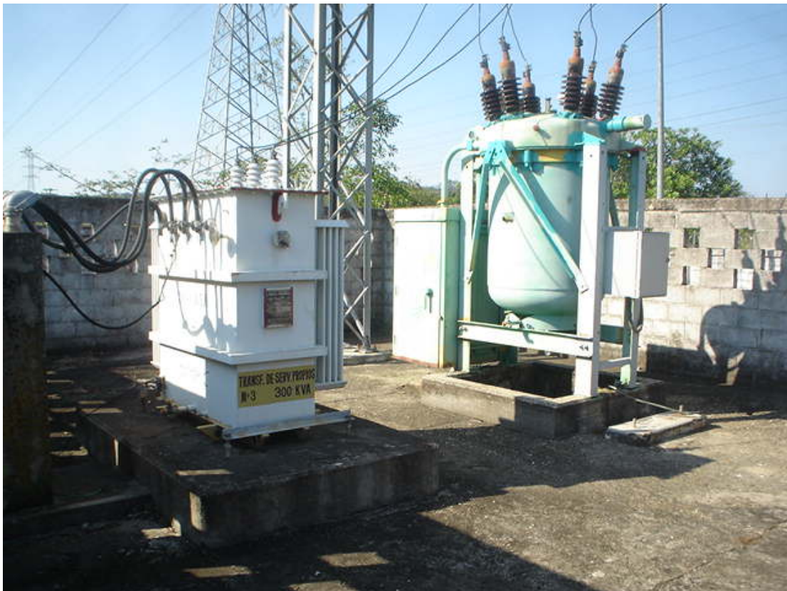
Figura 4.6.1 Transformador tipo estación de 300 kVA, de los Servicios Propios
