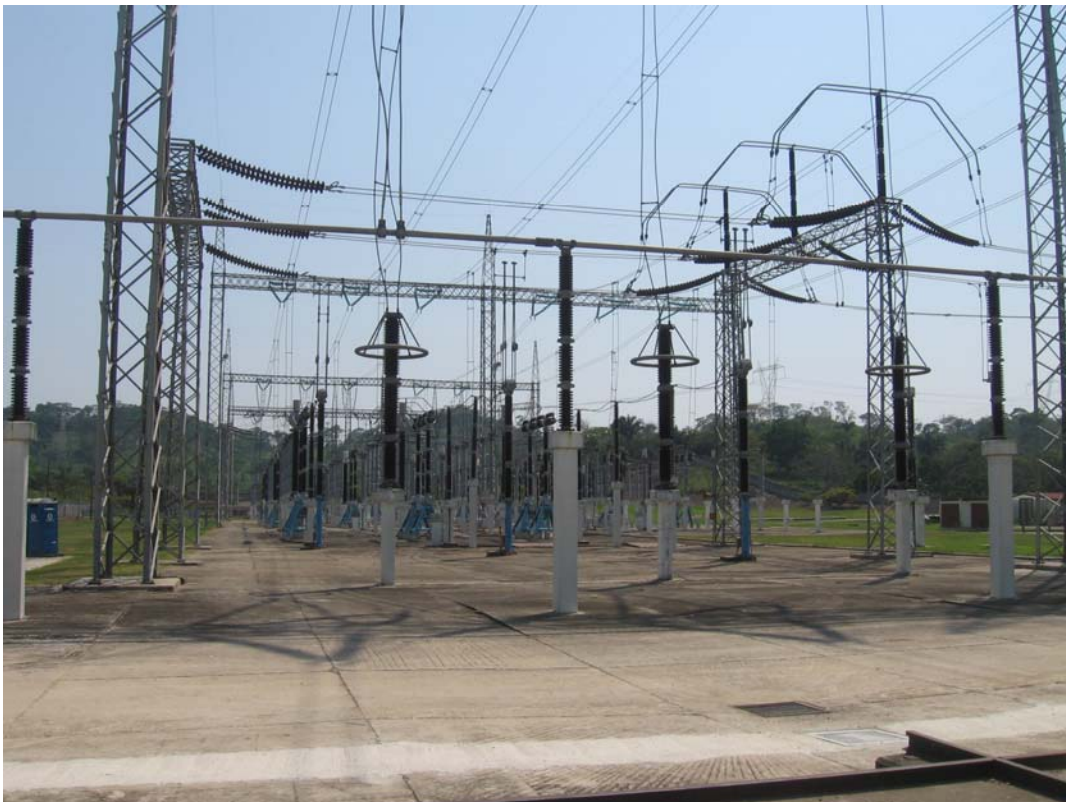
Figura. 5.1 Área operativa de 400 kV, de la S.E. Coatzacoalcos Dos.
