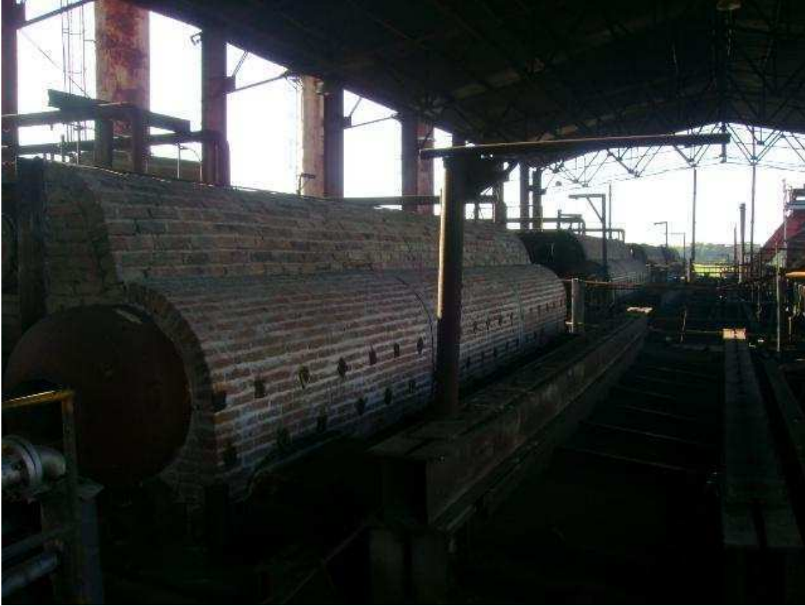
Figura 3.3. Vista lateral del sistema de calderas del ingenio Benito Juárez.
