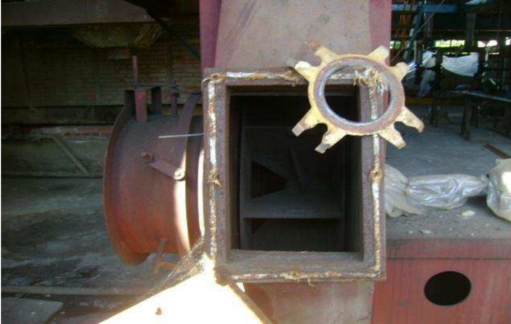
Figura 4.1. Vista lateral del ventilador centrífugo de extracción.
