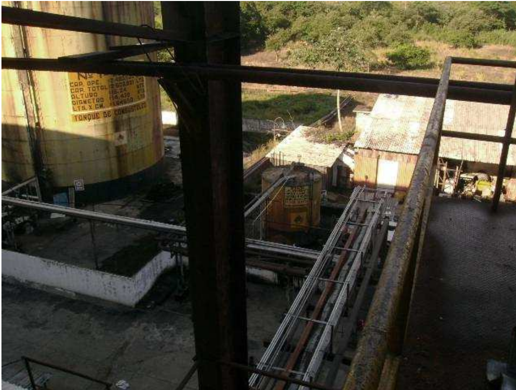
Figura 3.4 Tanque de almacenamiento de combustóleo con capacidad de 2, 480,000 litros y tanque de consumo diario de 48,000 litros de combustóleo
