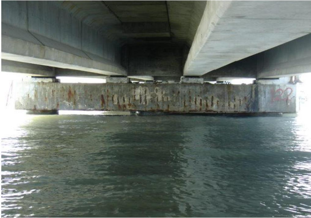
Figura 1. Puente El Zacatal, que conecta la Cd. del Carmen con el resto del continente. Acero expuesto, propenso a corrosión por penetración de cloruros. Juan Herrera Borja (2006).
