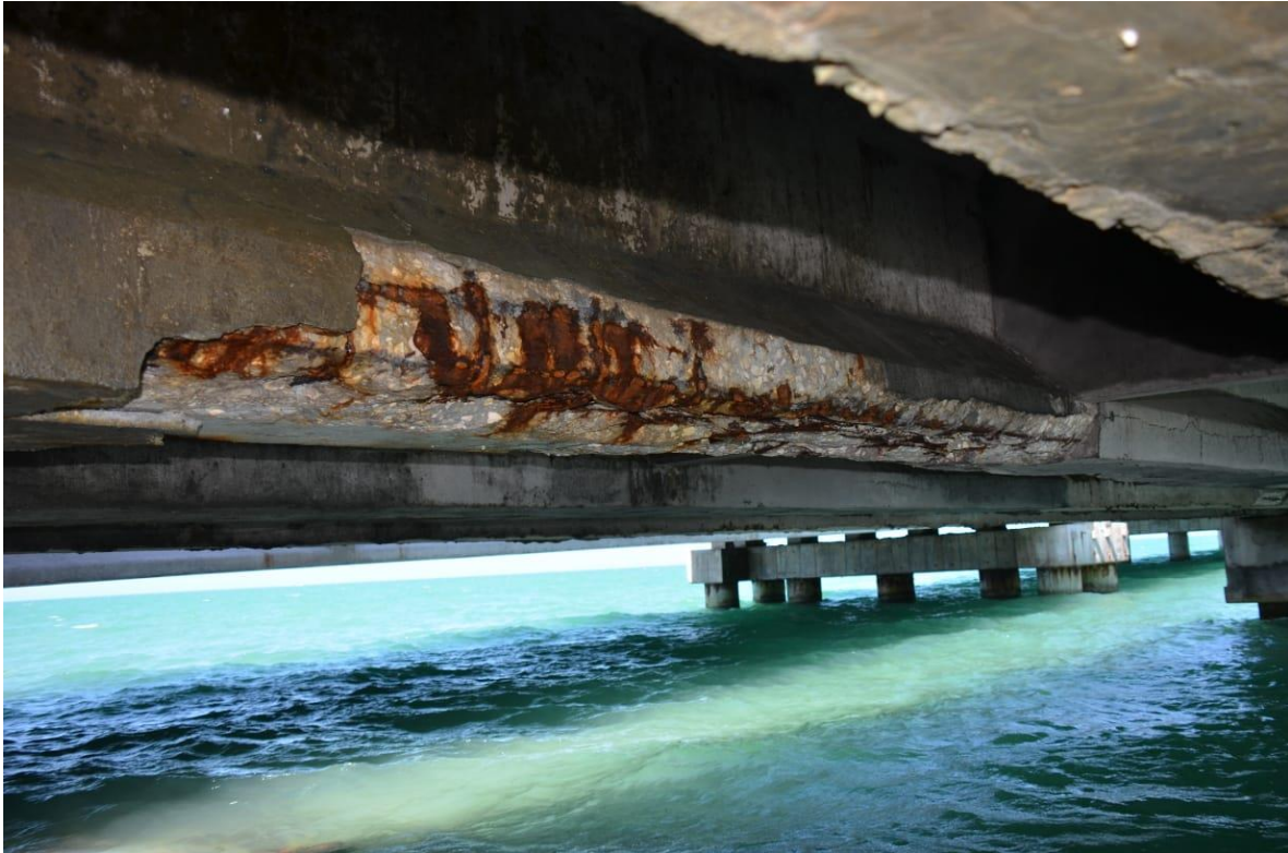
Figura 2. Acero expuesto en el puente La Unidad, que conecta Cd. del Carmen con la Península. Autor desconocido (2019)
