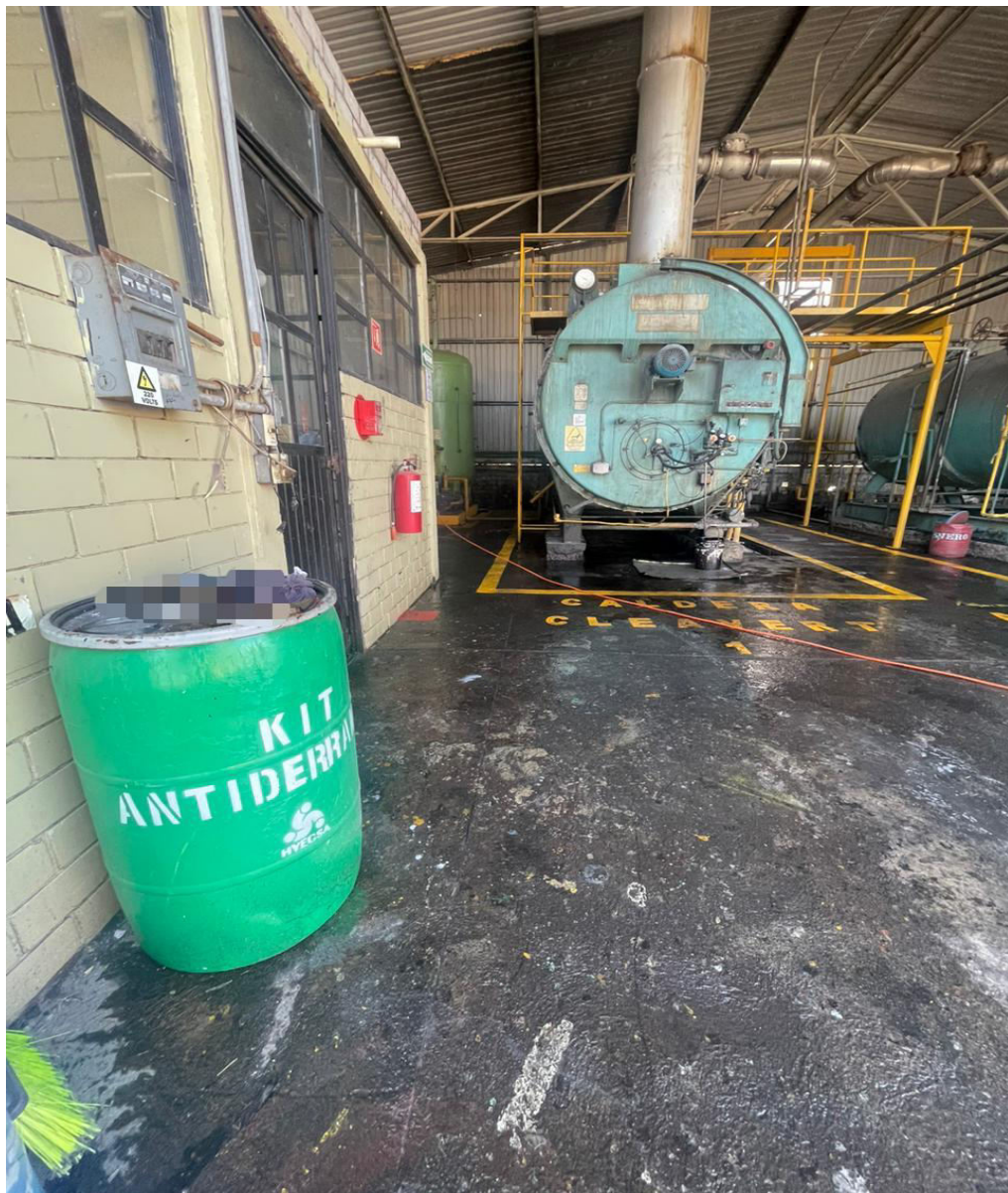
Ilustración 78 Kit antiderrames colocados en el área de calderas.
