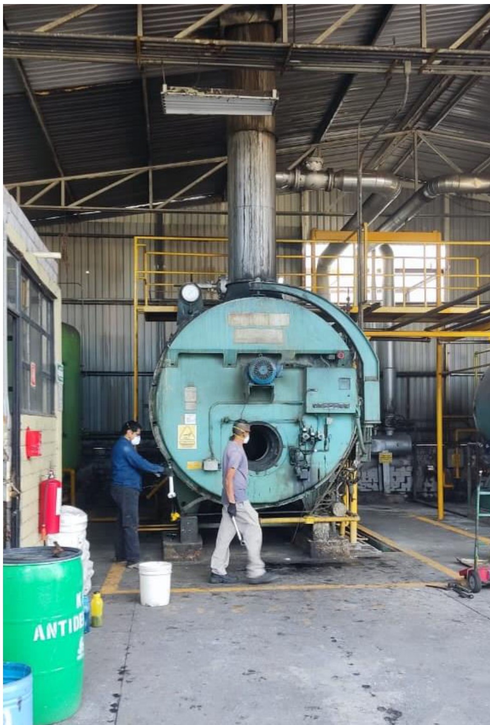
Ilustración 69 Inspeccionando el área de calderas para ejercer el plan de mantenimiento.
