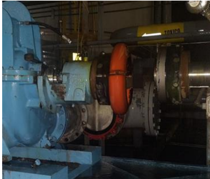
Figura 18 Cople Omega Motor-BBA dañado
