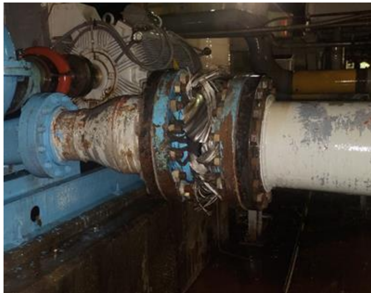
Figura 17 Junta de Expansión Dañada
