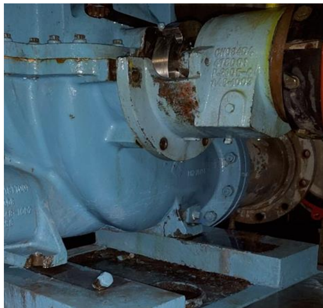
Figura 19 Cajas de Rodamientos del eje tanto lado cople como libre sueltos sin tornillos, tornillos capados de base
