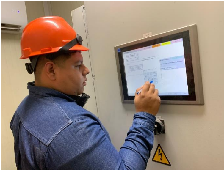
Figura 4.1 Operación de sistema de monitoreo de emisiones
