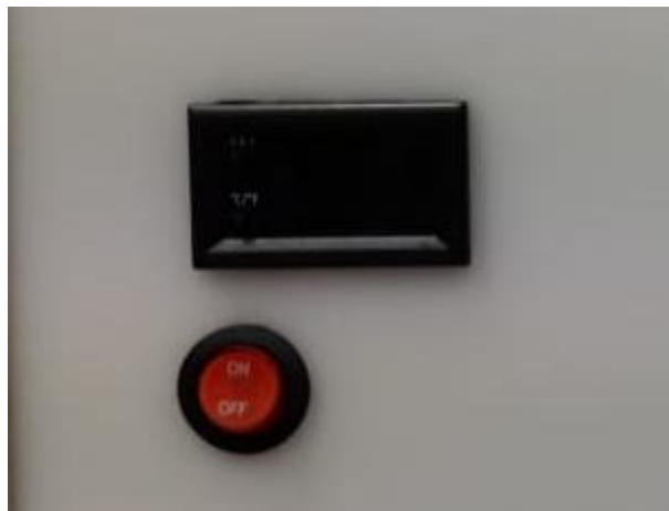
Imagen 26 Panel del termostato
