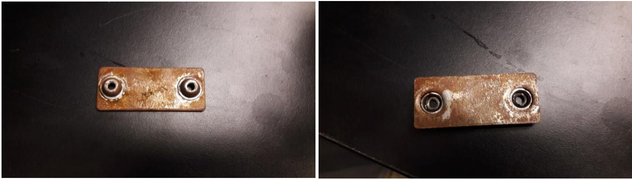
Imagen 16 Placa metálica con oxido
