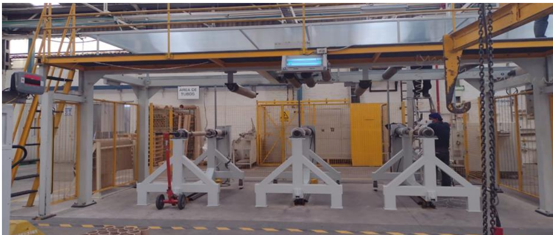
Figura 76 Área de Bobinado de Máquina Reifenhäuser línea de Extrusión
