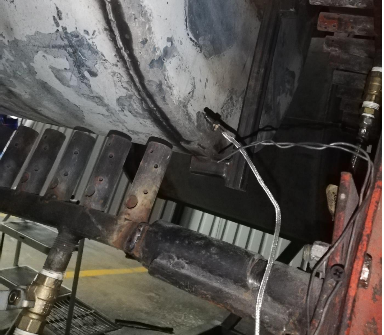
Figura 6.4 Colocación de sensor en máquina de flama abierta 1.
