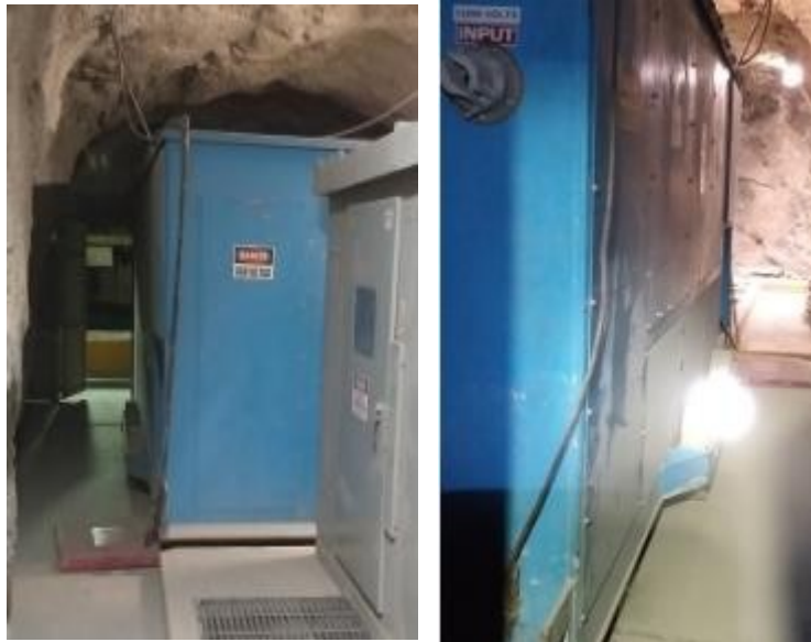
Figura 2.7.- Subestación eléctrica tipo blindada.
