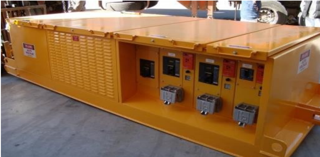
Figura 2.5.- Subestación eléctrica MINE POWER tipo interior.
