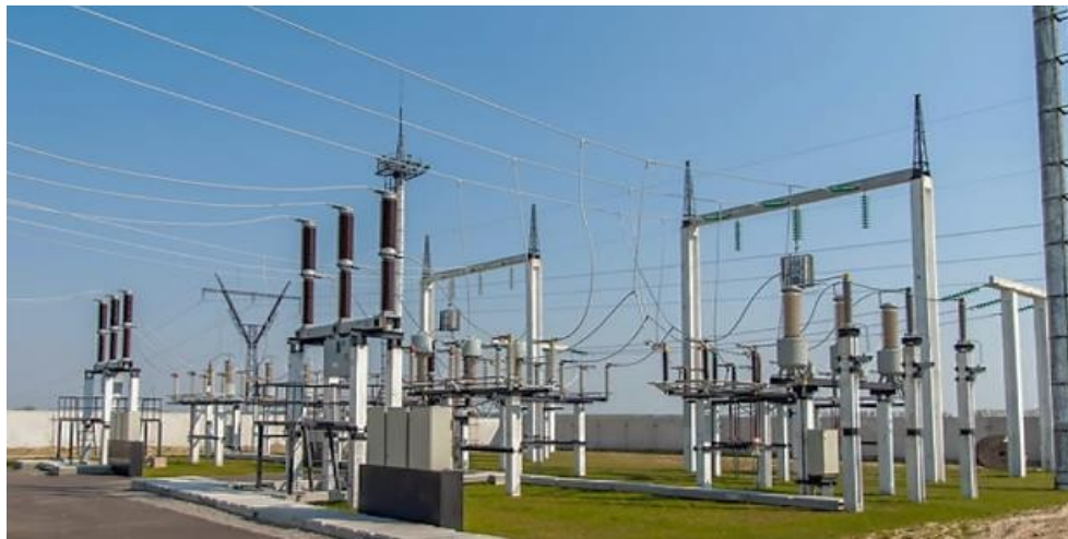
Figura 2.2.- Subestación eléctrica tipo intemperie.
