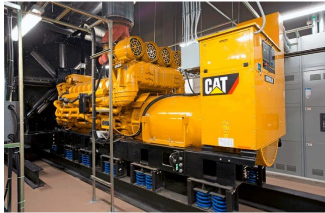
Figura 4.4 Grupo electrógeno instalado como fuente auxiliar en un hospital
