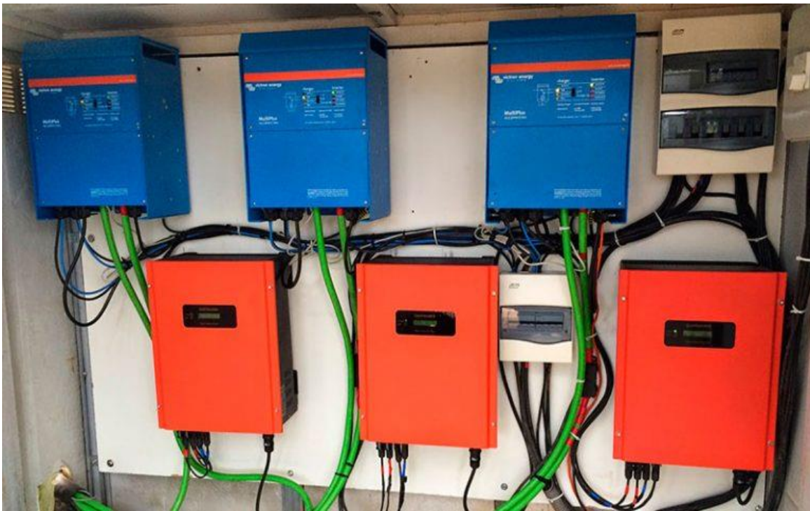
Figura 2.6 Inversores puestos en funcionamiento.
