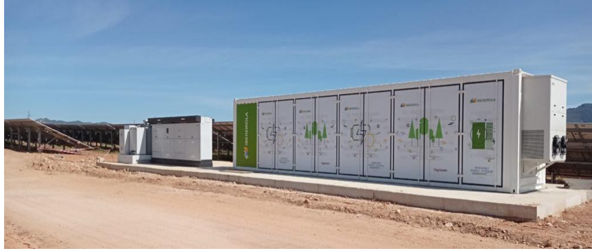
Figura 1.3 Power Station y el contenedor de baterías de Ingeteam en Arañuelo III, Cáceres.
