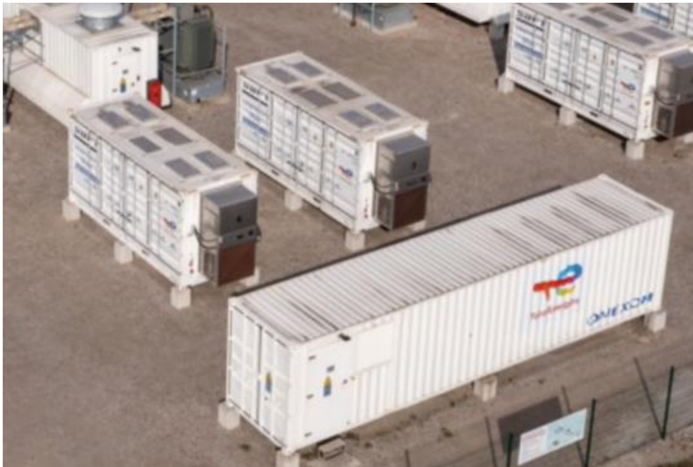
Figura 1.4 Proyecto de un parque de baterías destinado al almacenamiento de energía ubicado en Bélgica.
