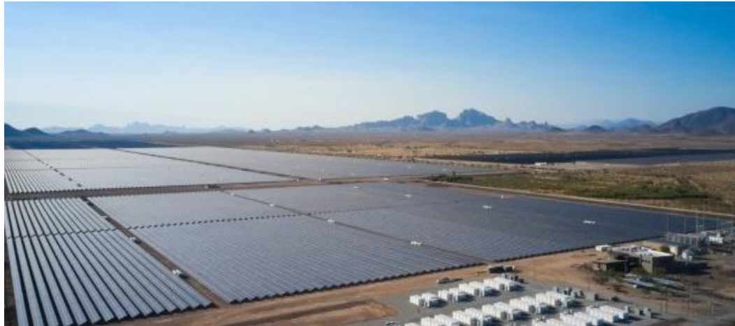
Figura 1.5 Proyecto de almacenamiento de baterías en Texas y Arizona para la energía fotovoltaica.
