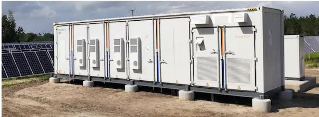
Figura 1.2 Instalación de un sistema de un sistema fotovoltaico con almacenamiento en baterías ubicado en Múnich Alemania.
