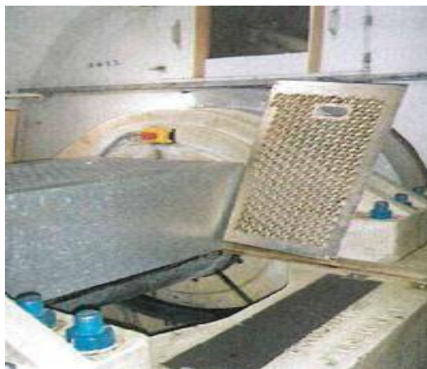
Figura 4.24 No abandonar la trampilla de la nacelle en posición abierta después de haberla utilizado.
