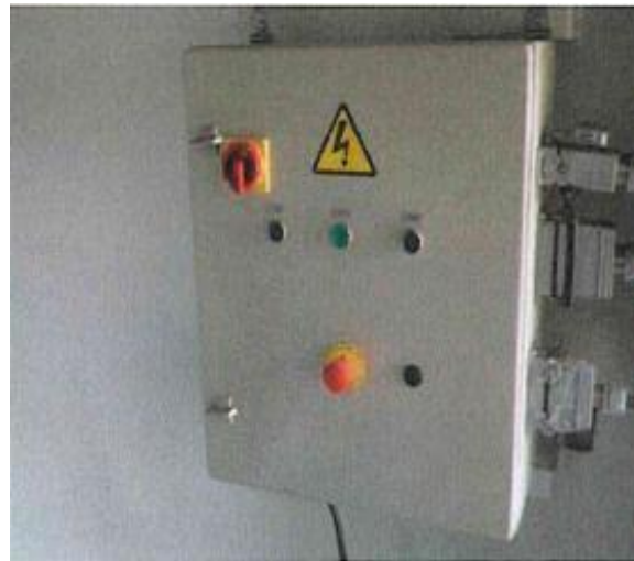
Figura 4.20 Armario de control del elevador situado en la plataforma del ground
