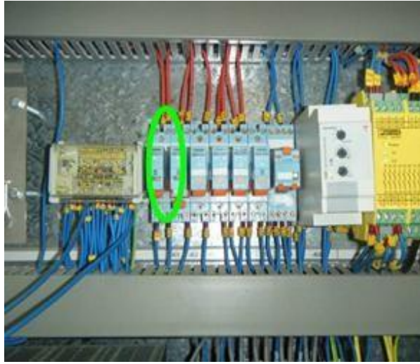
Figura 4.51 Relé K1 (gobierna el cierre del contactor del estator).
