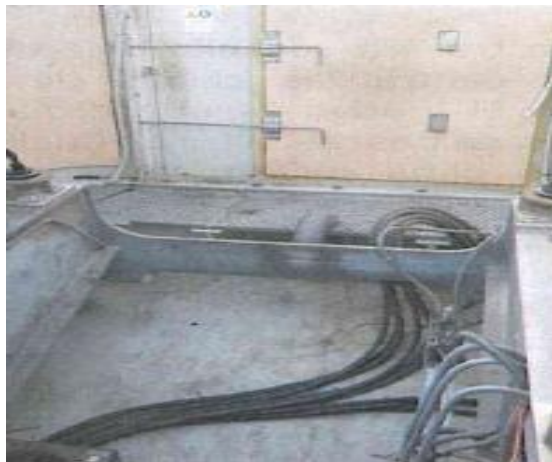
Figura 4.26 Detalle de la envolvente de fibra situada debajo del generador
