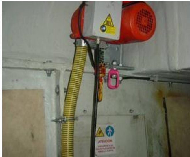
Figura 4.52 Punto de anclaje previsto para el montaje del descensor de emergencia. Capacidad nominal: 1 usuario máximo.
