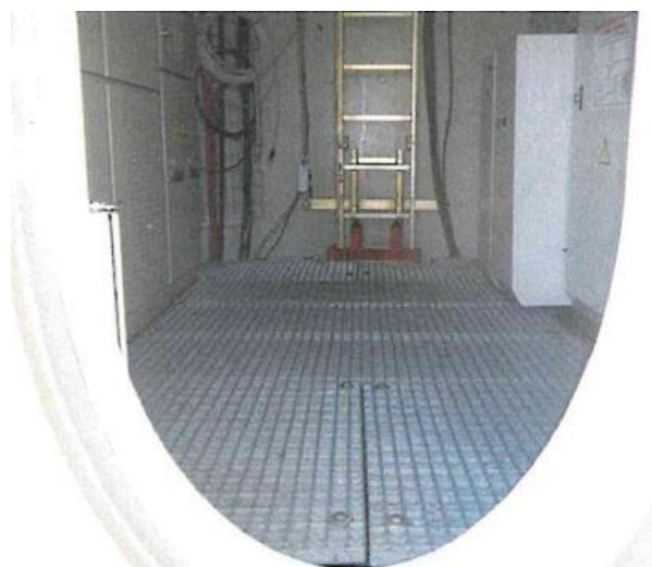
Figura 4.6 Detalle de la plataforma de tramex que cubre la cimentación en torres metálicas
