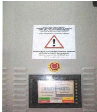
Figura 4.31 parada de emergencia en el armario ground
