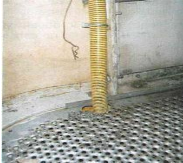
Figura 4.33 Zona de atasco de la cadena cuando se está recogiendo el polipasto si el tubo no está bien centrado.
