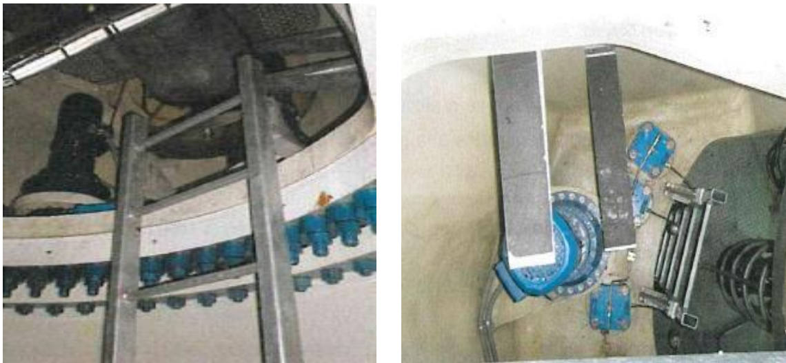
Figura 4.22 Detalles de la escalera de acceso a la nacelle desde la plataforma de la corona. En las torres de hormigón postensadas se ha sustituido la primera escalera fija por otra amovible.
