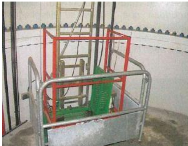
Figura 4.12 Detalle del hueco del elevador en una plataforma intermedia de una torre metálica
