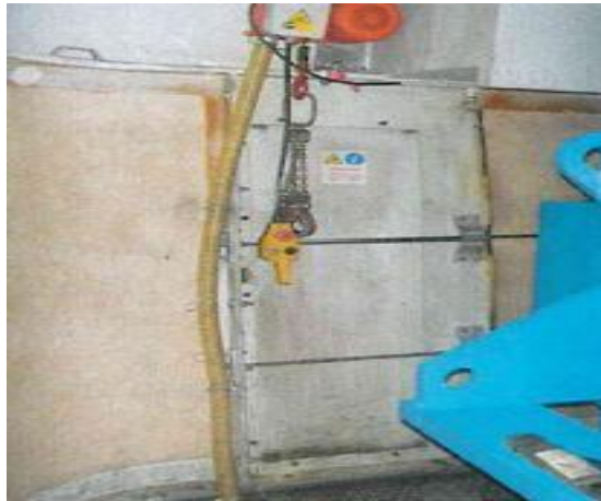
Figura 4.25 Puerta trasera cerrada y con la barra de seguridad colocadas
