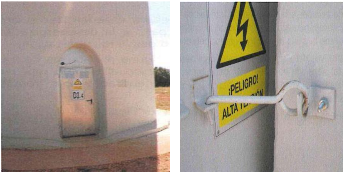
Figura 4.3 Detalle de la puerta en una torre de hormigón. No en todos los casos disponen de sistemas de retención
