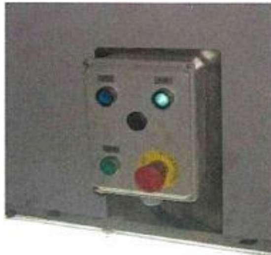
Figura 4.21 Cuadro de control del elevador en la plataforma de la corona.
