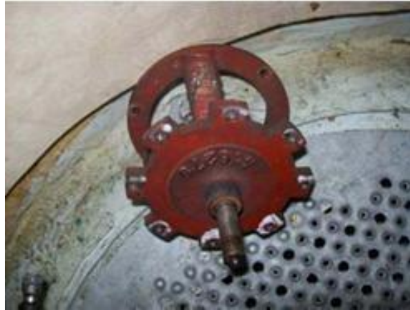
Figura 3.22 Una vez sueltos los cables de potencia quitar con llave de 13 la pieza que hace de soporte del ventilador
